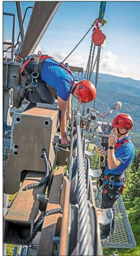
In großer Höhe führen David Haas und Jonas Wallner regelmäßige Wartungsarbeiten an den Stützen der Lifte durch. – Foto: Bergbahn
